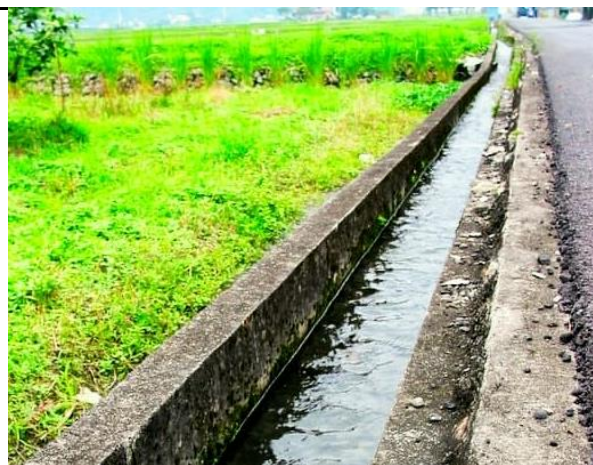
在農圳進水口能設置蛋殼淨水裝置確保水質的乾淨
